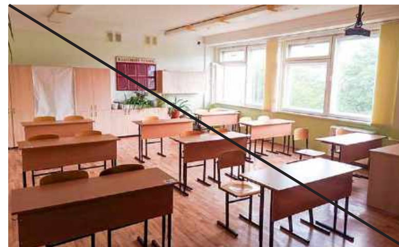
Плохо Линолеум под дерево
