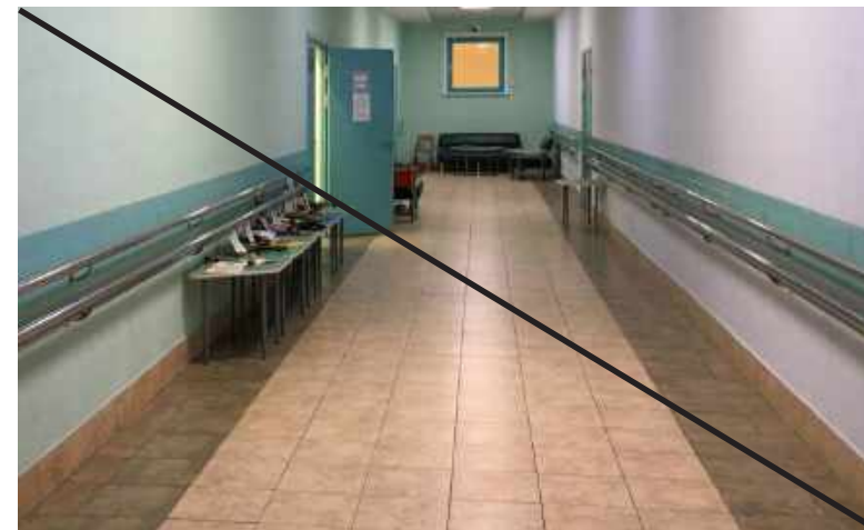
Плохо Керамогранитная плитка с крупными швами
